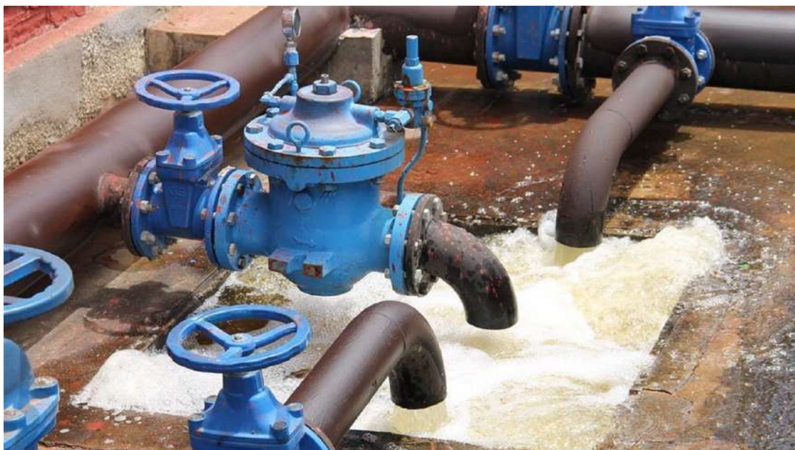
Alcantarillado afectado por la Dana. - Foto: AYUNTAMIENTO DE VALÈNCIA
